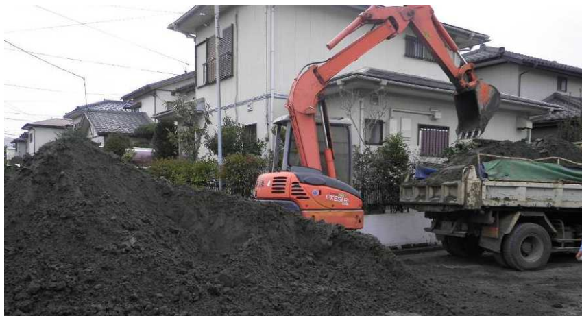
液状化現象で大量の土砂が噴出し、通行できなくなった道路（千葉市提供）
