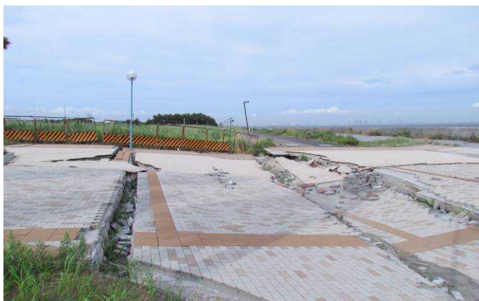
地割れを起こした公園（千葉市提供）
