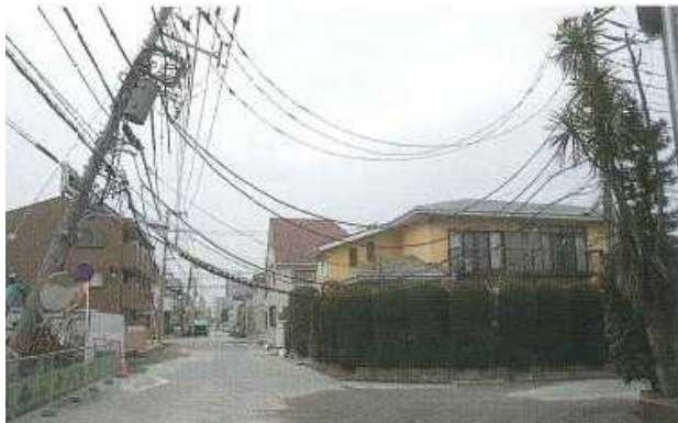
左 震災で傾き、倒壊寸前の電柱
