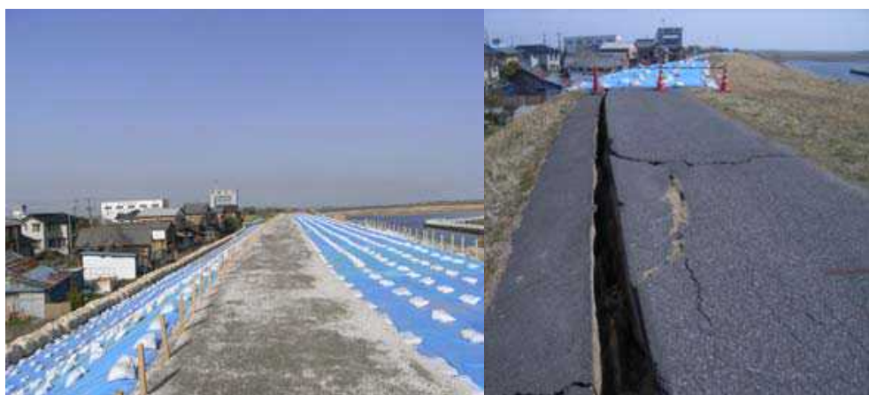
左：緊急災害復旧工事後 右：地割れが起きた堤防（利根川下流河川事務所提供）
